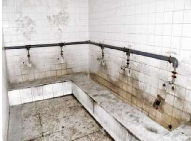
شكل "8" سوء التنفيذ والاهمال في أماكن الوضوء إحدى مشاكل تصميم المساجد
